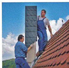
...die Hülle senkt man herunter bis sie noch etwas Abstand zur Blech-verwahrung hält...
